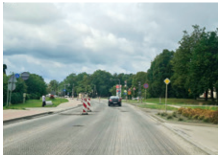
Nofrēzētais asfaltsegums Brīvības ielā
