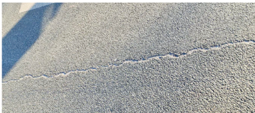
Brīvības ielas defekti – plaisas
