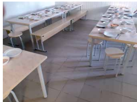
Augstkalnes pamatskolas virtuves grīda pirms remontdarbiem.
