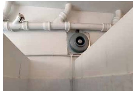
Dobeles Valsts ģimnāzijas tualesu telpas pirms remontdarbiem.
