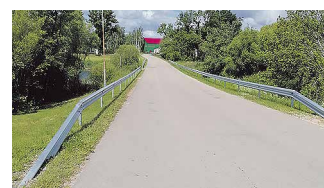
Ceļa drošības barjera uz autoceļa Nr. TE31 "Gravenieki-Pilādži-Jelgavas šoseja" Zelmeņu ciematā, Tērvetes pagastā.
