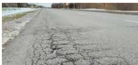
Defekti Tērvetes ielā, Dobelē.
